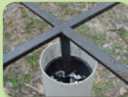
Cavalete em tubo PVC contendo óleo
